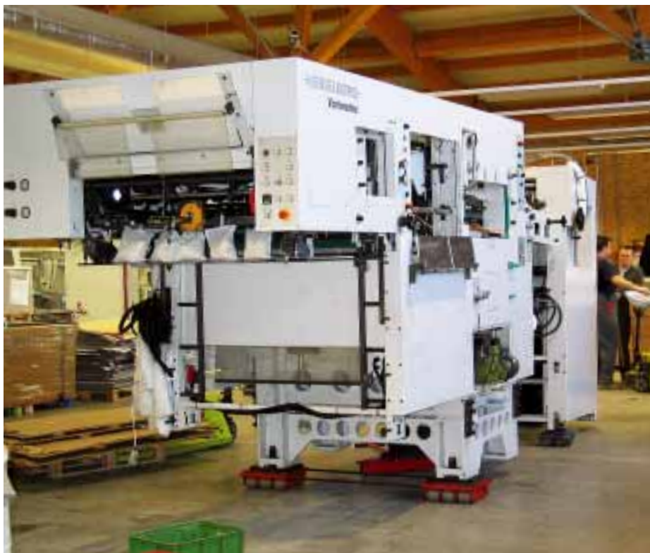
Varimatrix 105 před instalací ve společnosti Branaldi.
